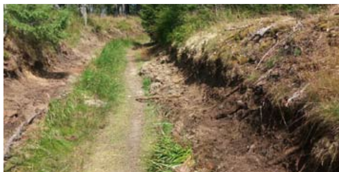
Foto stavu poškozených břehů (foto: archiv KML)
